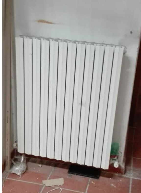
Fig.8 – Caloriferi in ghisa all'interno dell'immobile
