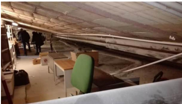
Fig. 9 – linea di distribuzione termicamente isolata nel sottotetto
