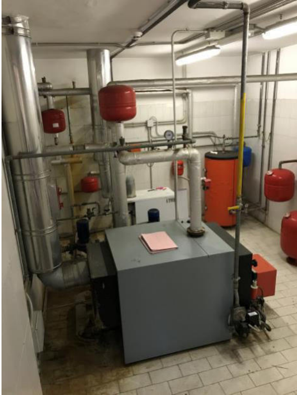
Fig.7 – Immagine della centrale termica: in evidenza le due caldaie a basamento per i servizi riscaldamento e ACS
