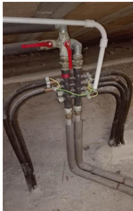
Fig. 10 – I collettori di distribuzione posizionati nel sottotetto
