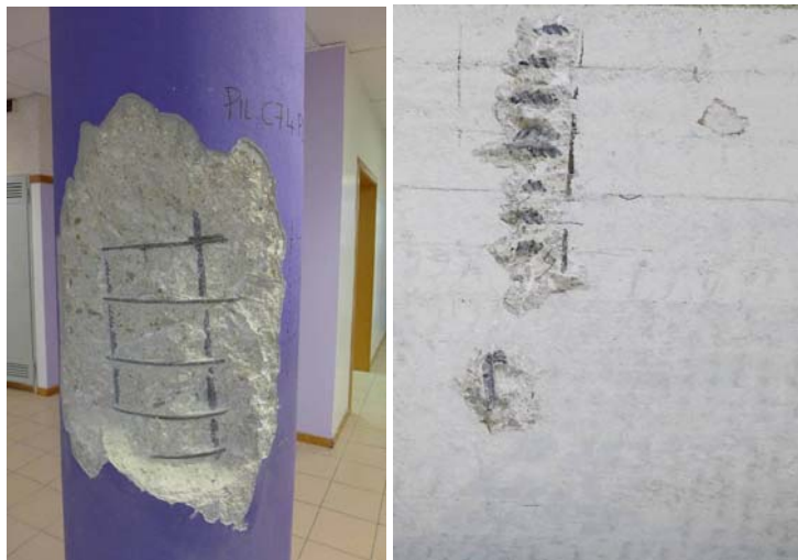
Armature e copriferri irregolari sui pilastri e armature affioranti nelle travi
