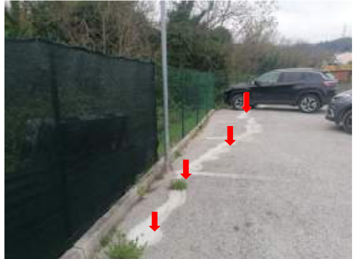
Foto 2: lesioni sull'asfalto dell'area parcheggio
