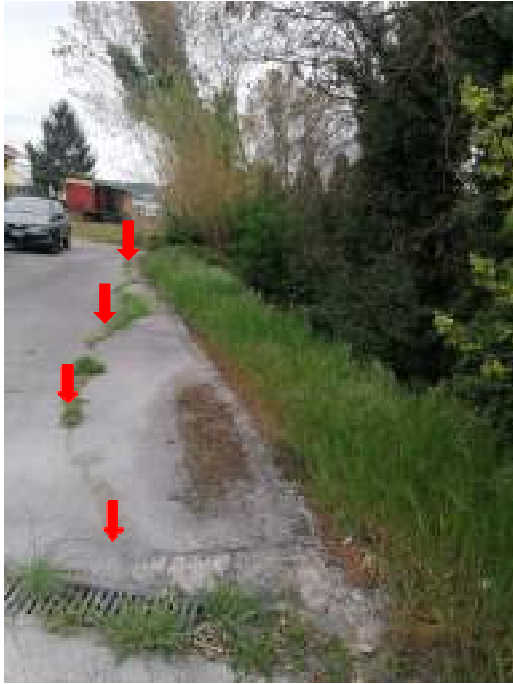
Foto 1: lesioni sull'asfalto in corrispondenza del ciglio della scarpata
