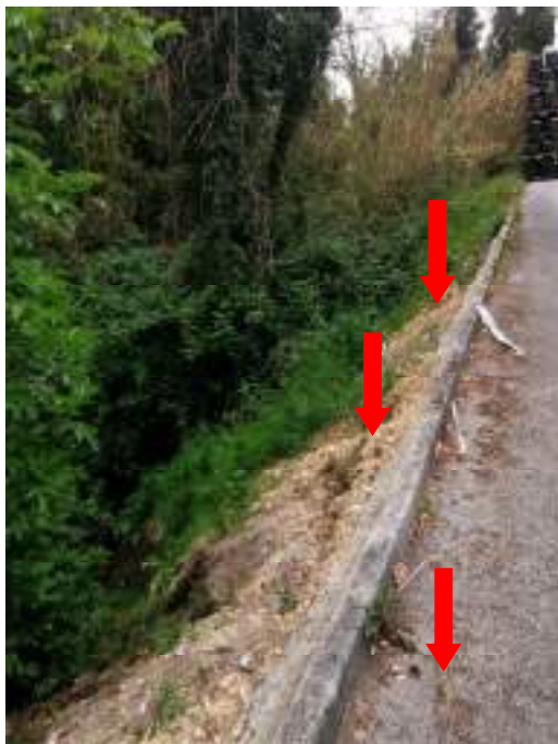
Foto 3: lesioni sulla scarpata naturale che stanno raggiungendo l'area asfaltata
