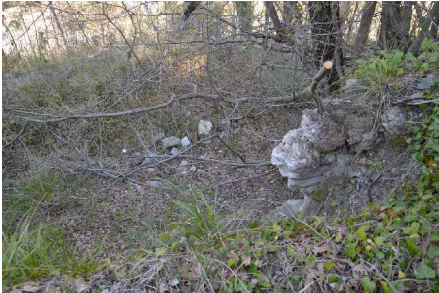
Foto – Muro a secco caduto
