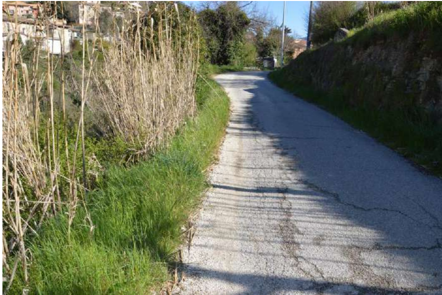
Foto – Fessurazioni in corrispondenza della porzione Nord del tracciato
