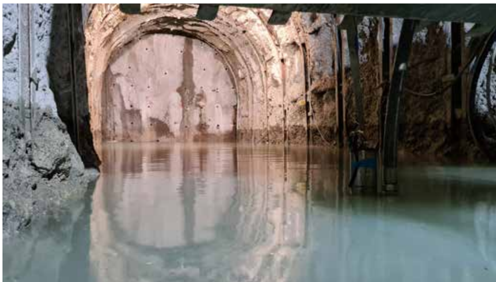
GALLERIA PESCARA PRIMA DELLA ROTTURA DELLA MEMBRANA
