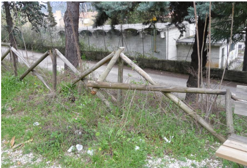
balaustra in legno distrutta
