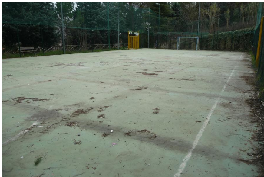
Pavimentazione in resina degradata
